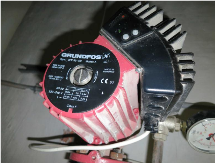
Figur 2. Ældre cirkulationspumpe som anbefales udskiftet til sparepumpe.
